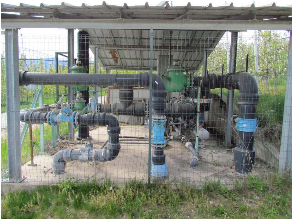
Figura 5 | Stazione di filtraggio gestita dal Consorzio irriguo e di miglioramento fondiario di Coredò (Tn). Fonte: autore.
