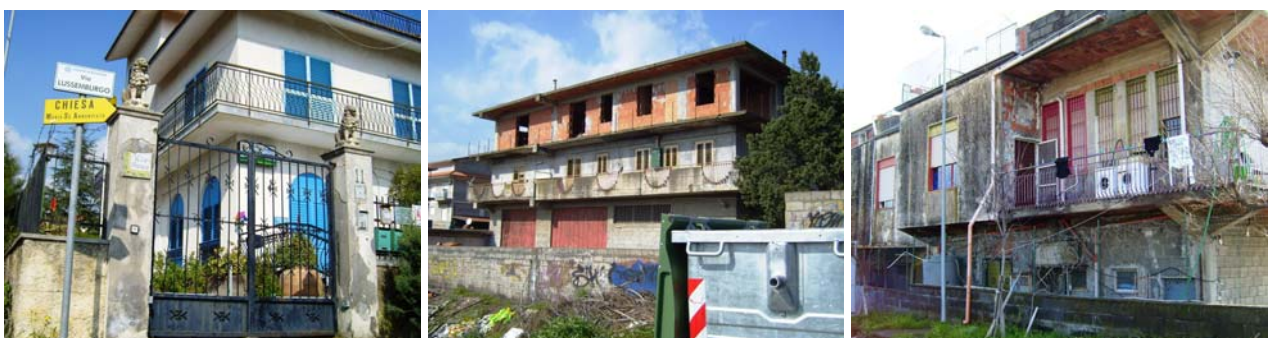
Figura 9- Villaggio dei Pini-Le Ginestre: abitazioni e urbanizzazioni incomplete
